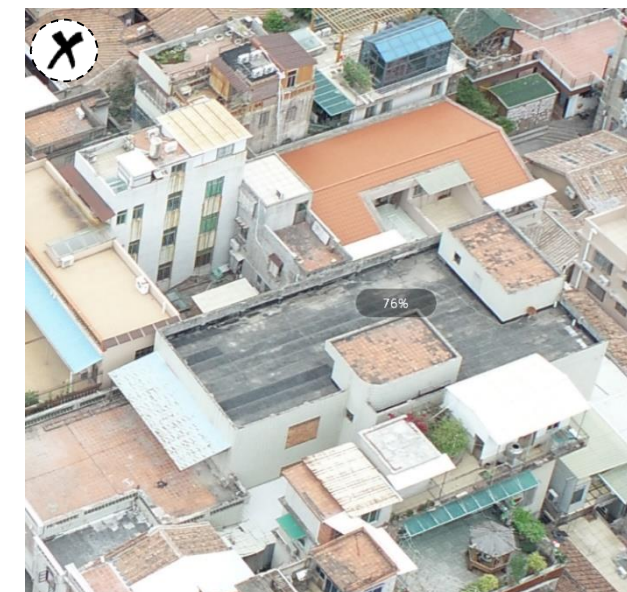
屋面防水层直接裸露
